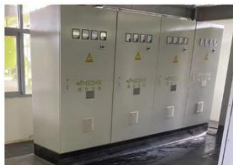
PLC 控制技术应用现场
